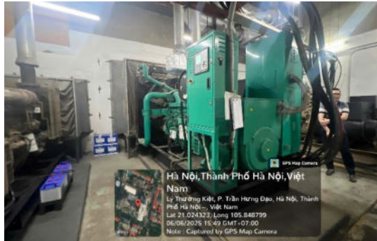
Máy phát điện dự phòng công suất 825kVA (cấp điện cho toàn bộ Khách sạn và khu dịch vụ)
