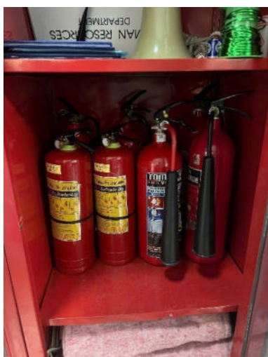
Bình bột chữa cháy
