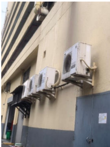
a) Dàn nóng điều hòa
