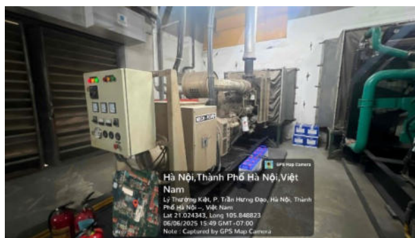
Máy phát điện dự phòng công suất 250kVA (cấp điện chiếu sáng, thang máy cho Khách sạn)
