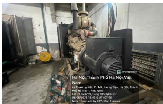
Máy phát điện dự phòng công suất 625kVA (cấp điện cho toà văn phòng)
