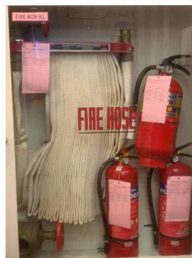
Vòi chữa cháy
