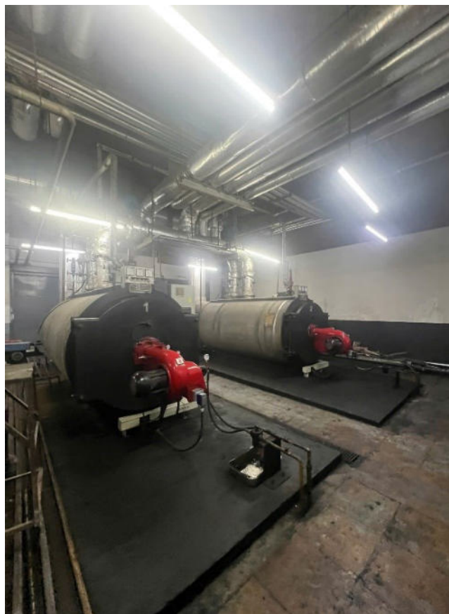
Lò đun nước nóng (LOOS Germany) công suất 1900KG/hr (tạo nước nóng sử dụng và cho điều hòa nóng vào mùa đông)
